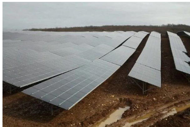
Parc photovoltaïque de Sarrazac Source : France 3
