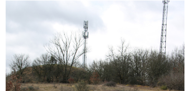
Antennes sur pylônes, hauteurs de Souillac Source : ARTIFEX 2022
